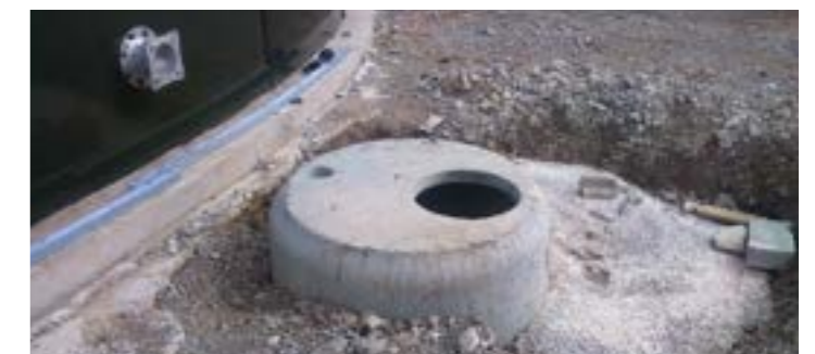
2m 3 (440 gal) Spill tank
