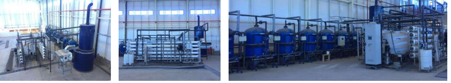
Proses suyu Arıtma Sistemi
