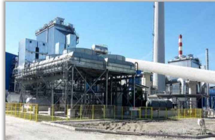
4,8 MW BULGARIA PROJECT
