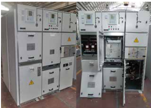
ALGERIA - Centrali di generazione mobili in container Diesel Generator Power skids
