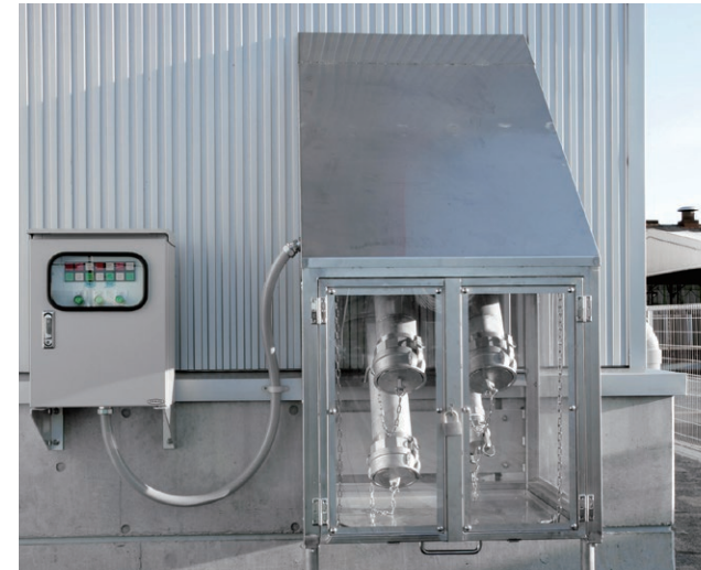
ローリー接続口 Lorry end connection
