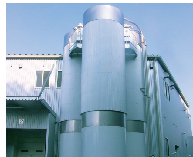
屋外サイロ Outside PowSilo
